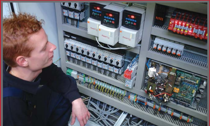
Timo Hamoen, engineer bij G.O.S aan het werk bij de schakelkast van de nieuwe dry offset printing machine
